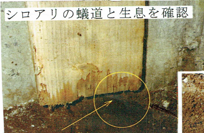
シロアリの蟻道を確認 シロアリも生息している。
